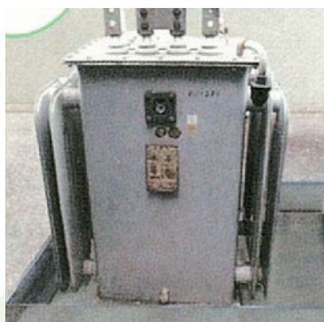
高圧トランス
