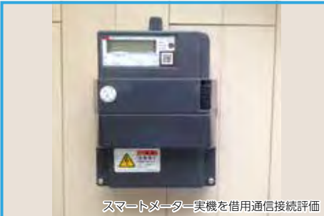
スマートメーター実機を借用通信接続評価
