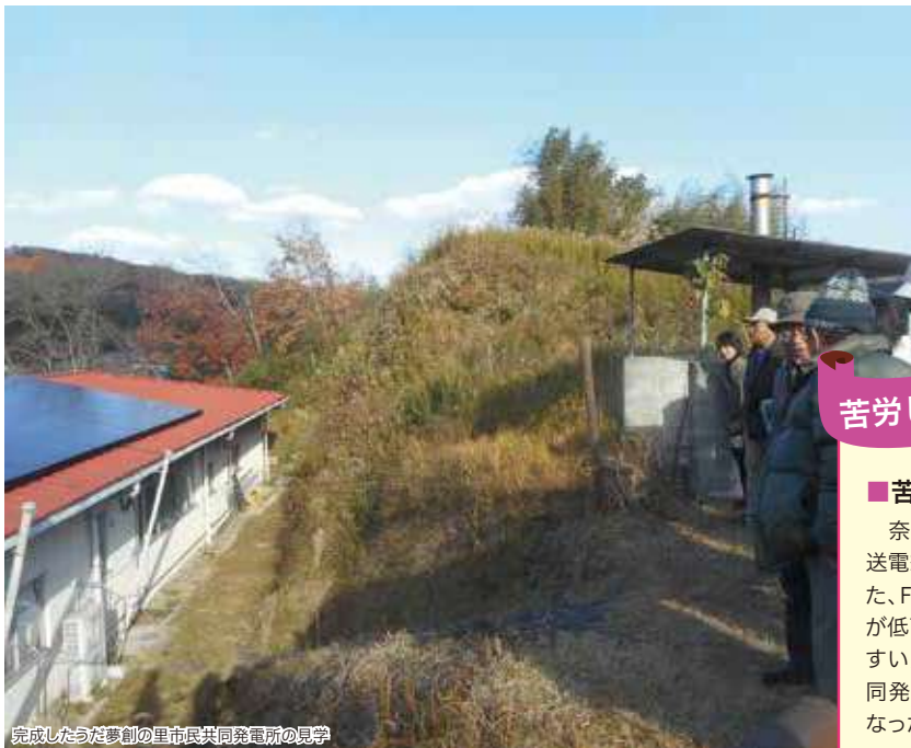
完成したうだ夢創の里市民共同発電所の見学
