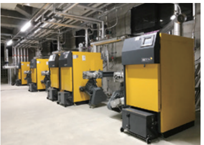
木質バイオマス熱利用をするためのボイラー(山梨県のゴルフ場へ導入)
