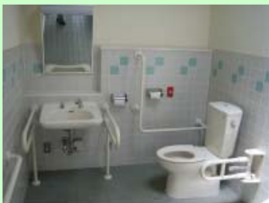
n. 自動水栓、節水型便器
