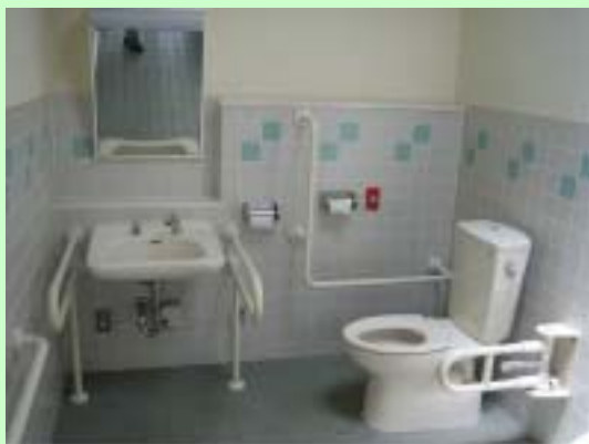
n . 自動水栓、節水型便器
