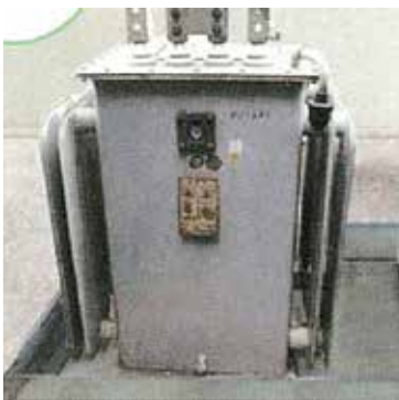
高圧トランス
