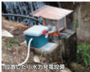
設置した小水力発電設備
