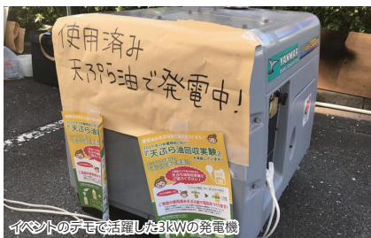
イベントのデモで活躍した3kWの発電機
