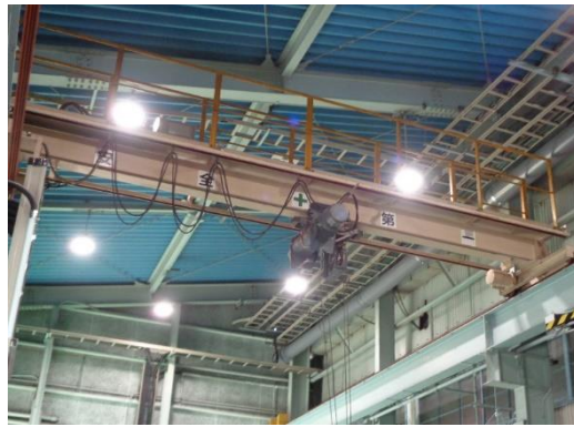
図2.8 天井クレーンの例
