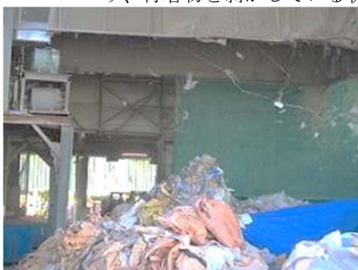
写真(4)-5 手選別ライン後の混合廃棄物は風力選別で比重差選別される
