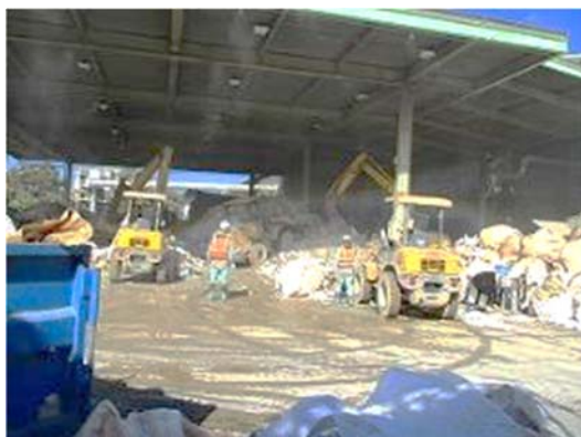
写真(4)-1 混合廃棄物処理ヤード全景
