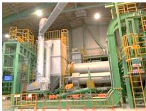
写真(4)-28 再生無水石膏焼成キルン (設定温 度：800℃、処理能力60トン/日)
