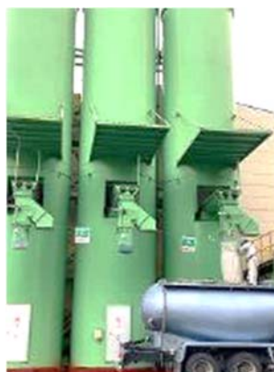
写真(4)-30 保管用サイロ (50 m³×3基)
