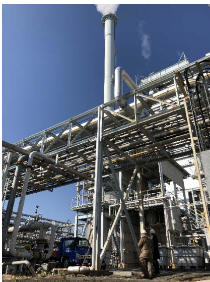
写真4.4.3 クレハ火力発電所
