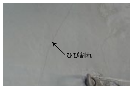
写真 4.2.1 ひび割れ発生状況
