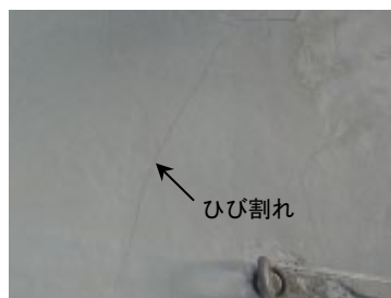
写真 4.2.4 ひび割れ発生状況
