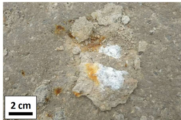
図 4.3.6 固化式処分埋立地盤の表層のポップアウト
