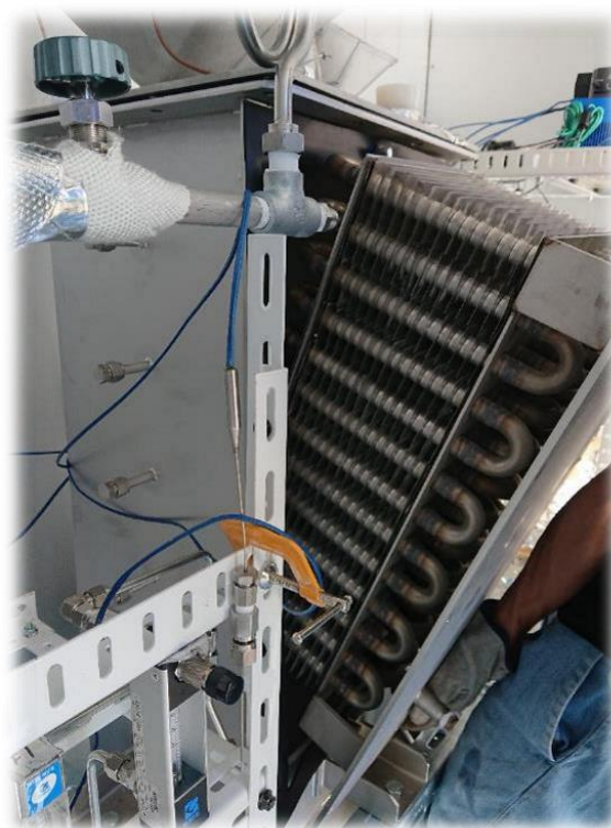
図8 ゼオライトボイラ内部に格納されているプレートフィンチューブ式熱交換器
