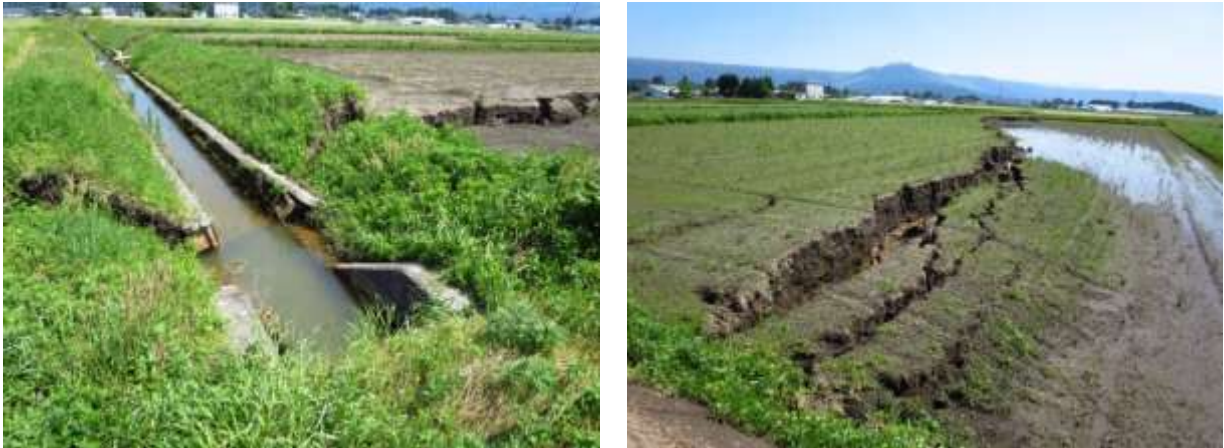
図 3.2 阿蘇市における水田被害状況。 左：用水路の破損。右：水田内の地割れ。
