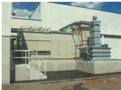
アンモニア冷却機 全景
