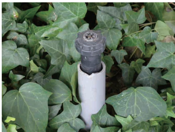
スプリンクラー (首都高速 5 号池袋線 (東京都板橋区))
