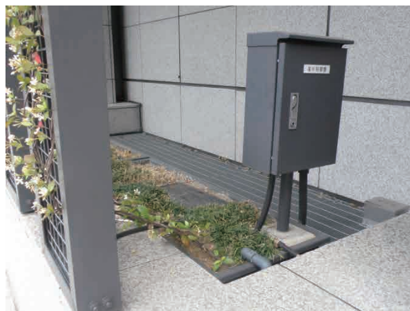
自動灌水設備 (経団連会館 (東京都千代田区大手町))
