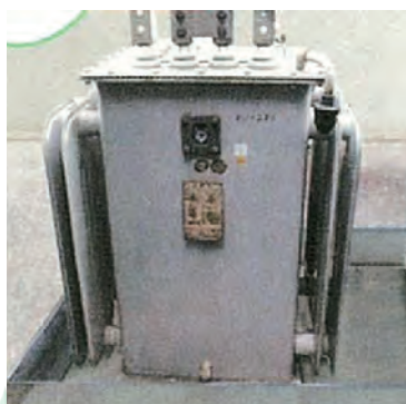
高圧トランス
