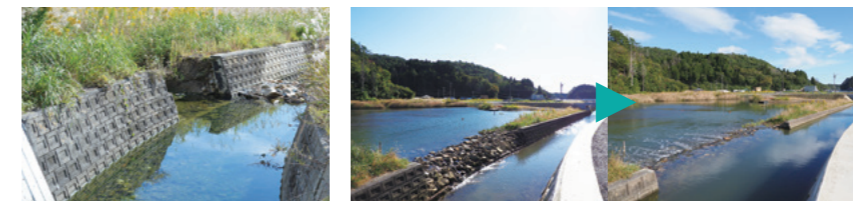
水の循環を確保するため、河川護岸を開削 干潮時に湿地の水が川に流出し、満潮時に海水が流入する(右)
